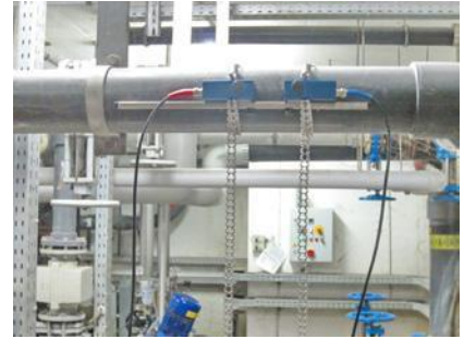
Thermal energy metering at Stadtwerke München
