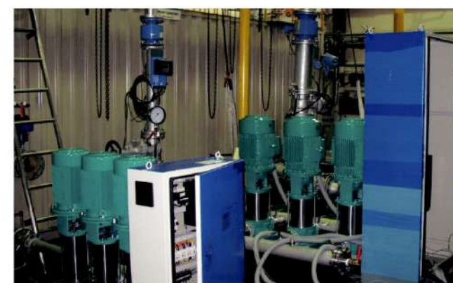
Vận hành thử nghiệm hệ thống Booster
